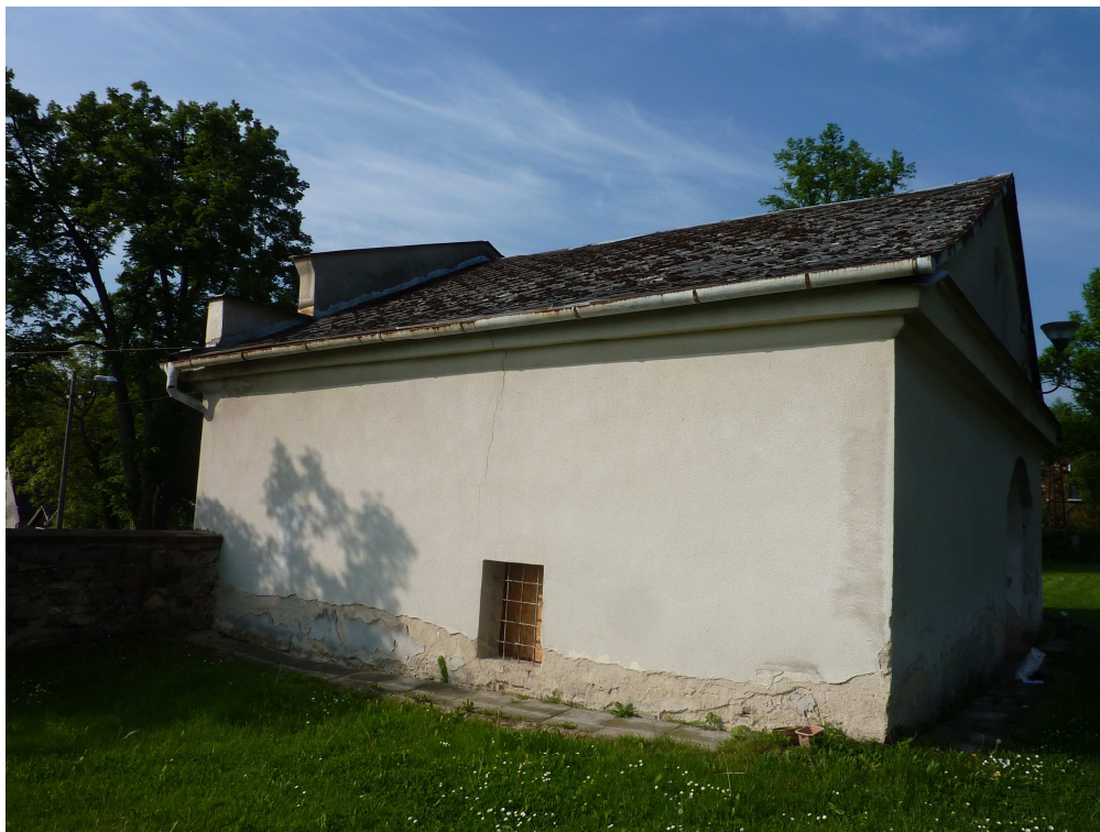
Foto 3 – vlhká pata zdiva a trhlina v obvodovém zdivu
