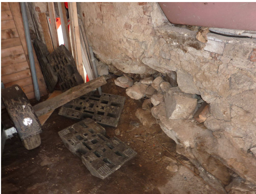
Foto 4 – vypadlé prvky (kameny) základového zdiva ve skladu
