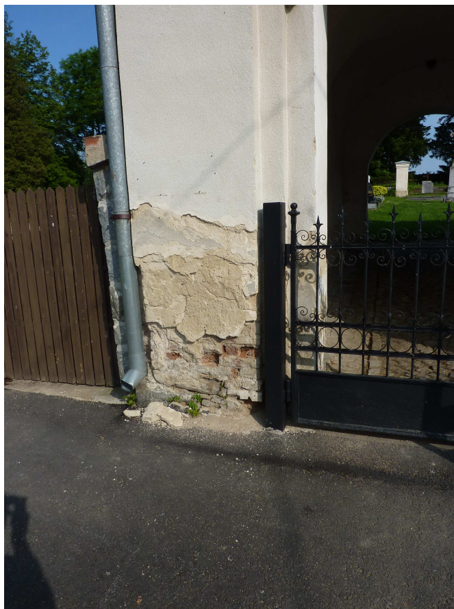
Foto 1 – poškozená pata zdiva jihozápadního rohu
