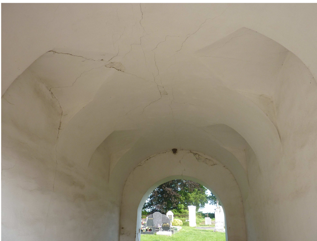
Foto 6 – trhliny ve stropní klenbě – průchod na hřbitov
