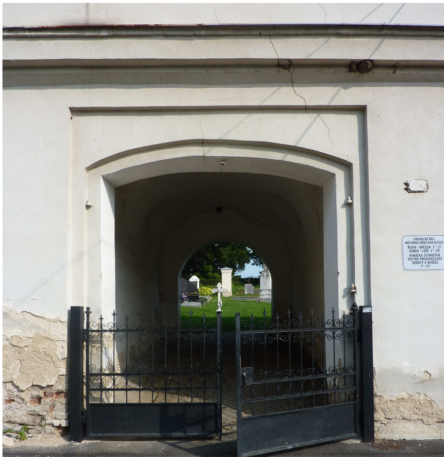
Foto 7 – trhliny v klenbě nadpraží a zdivu štitu poklesem podpory
