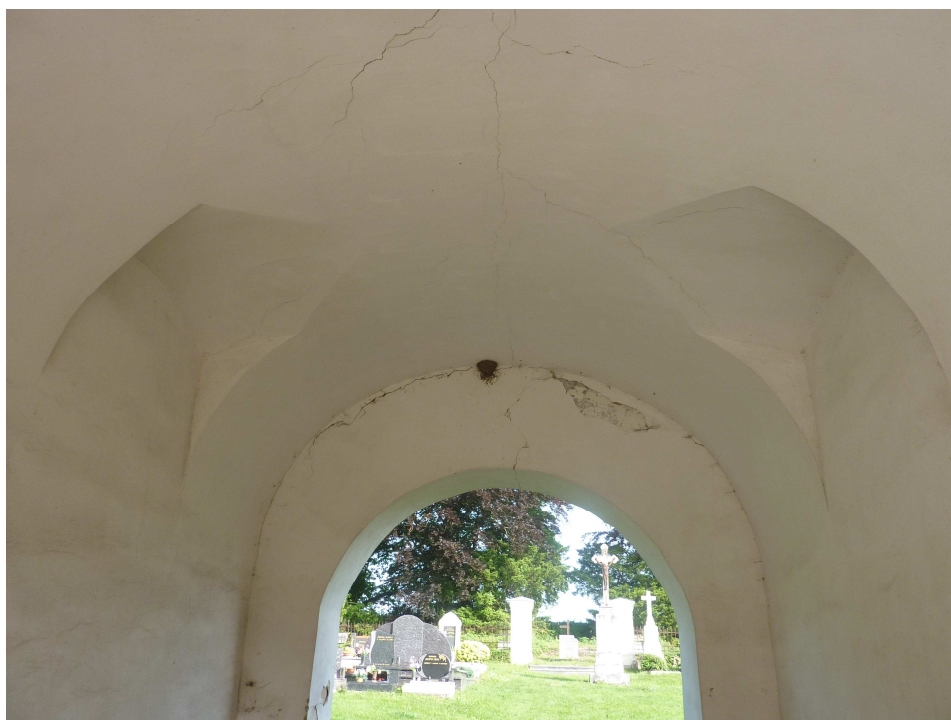
Foto 8 – trhliny v klenbě nadpraží
