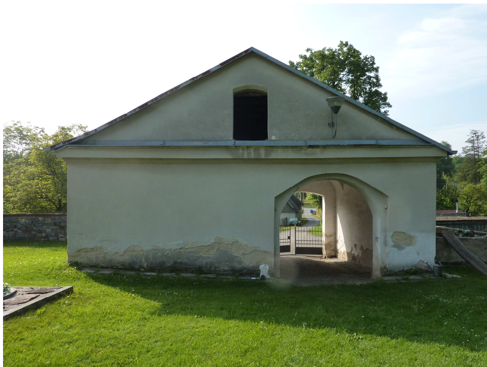
Foto 2 – vlhká pata zdiva a poškozená omítka
