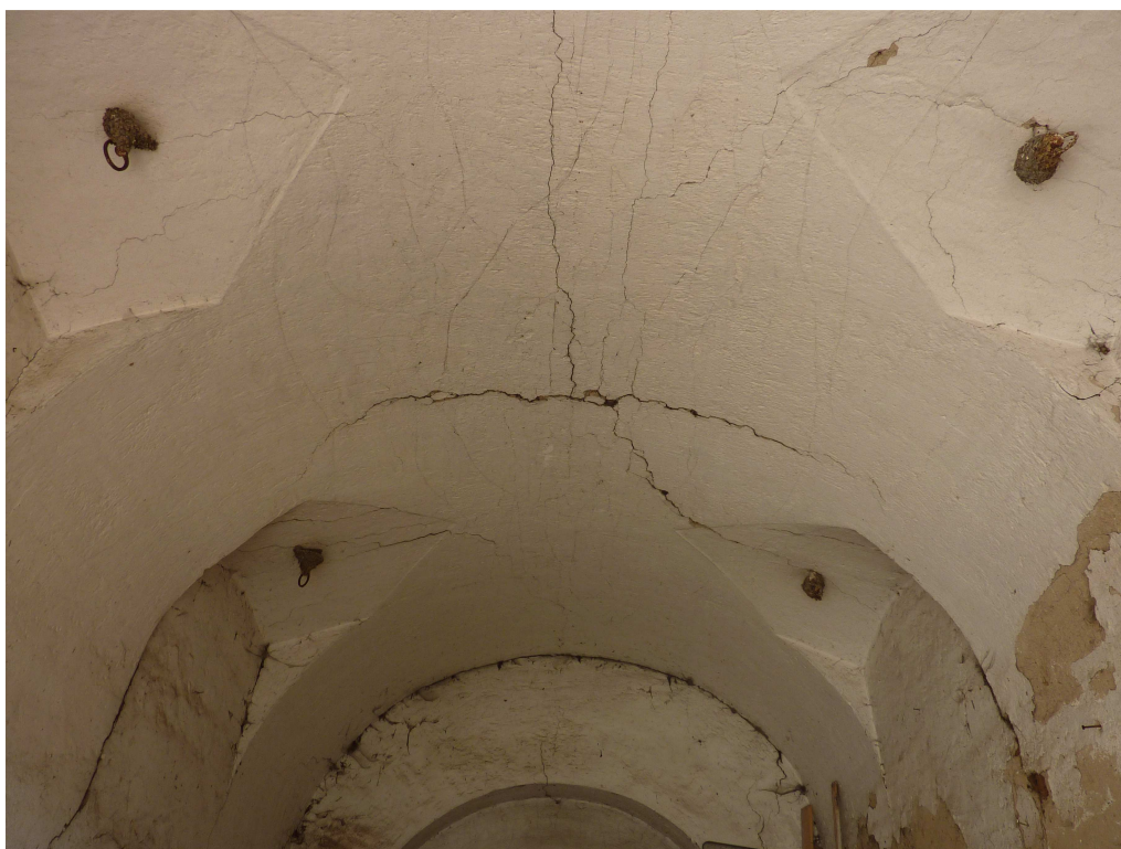
Foto 5 – trhliny ve stropní klenbě - sklad
