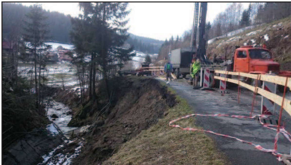
Obr. č. 1: Celkový pohled na svahovou deformaci
